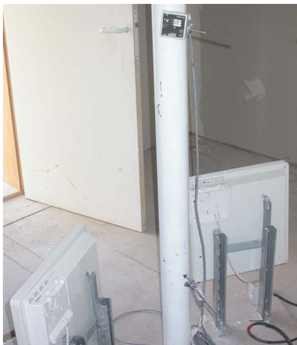
Photographie 5 : Vue des radiateurs et de la sonde de régulation
