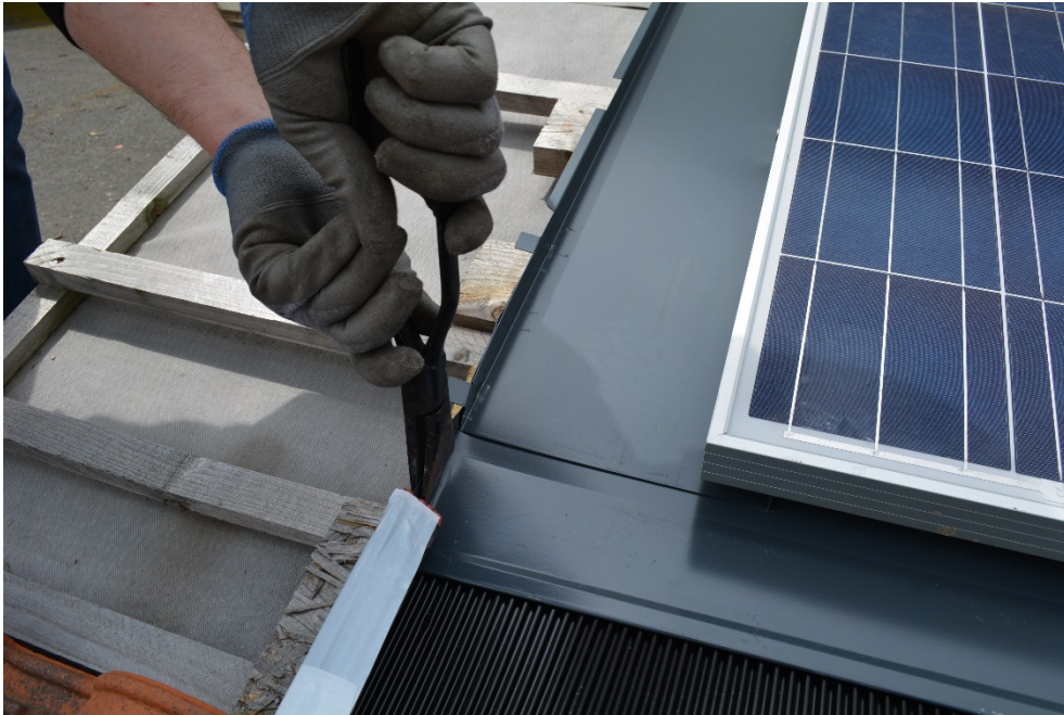
repli de la bavette avant sur le bord du couloir latéral
