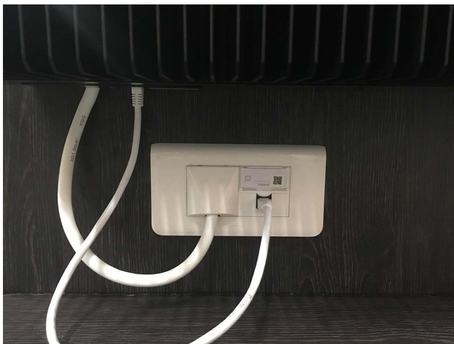
Figure 7 – Prise dédiée au Q.rad comprenant l'alimentation électrique et le réseau LAN avec flashcode permettant l'identification de chaque Q.rad
