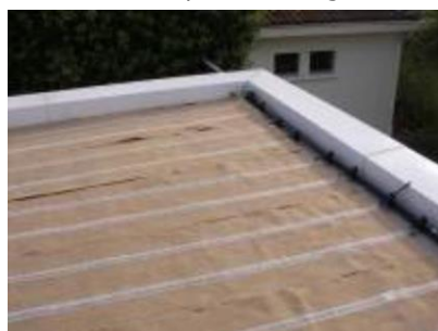
Figure 3 - Tapis d'irrigation Vertige® installé sur la toiture avec tuyaux d'irrigation intégrés
