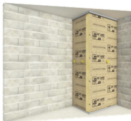
2. Mise en œuvre de l'isolant et verrouillage des platines. Contrôle de la planéité
