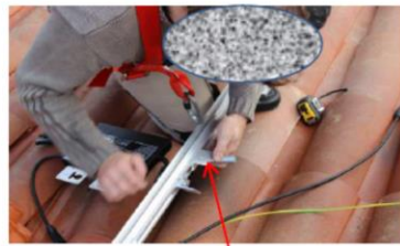
mise en place des équerres du micro onduleur sur rail support module
