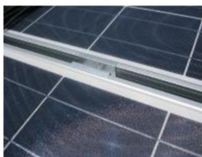
Milieu du champ PV entre modules
