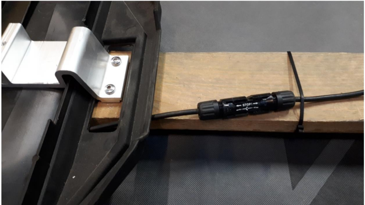
Figure 13 – Cheminement des câbles sous les cadres polymère et leur fixation par collier de câblage
