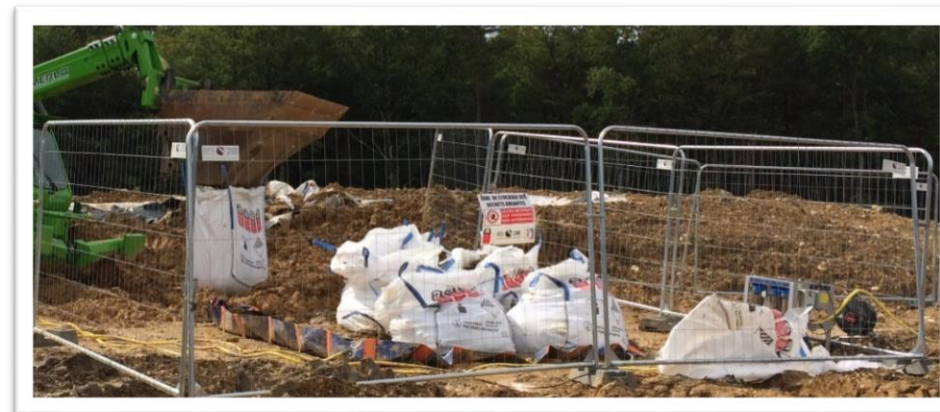
Aire de lavage des big-bags
