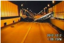
Effondrement du plafond du tunnel Sasago (Japon)
