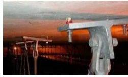
Arrachement des chevilles du tunnel Big Dig (USA)
