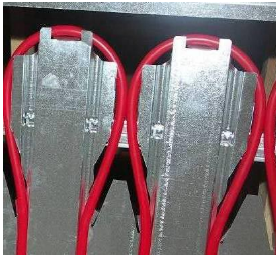
Figure 4 - Détail du passage du tube à l'extrémité du diffuseur (vue de dessous)
