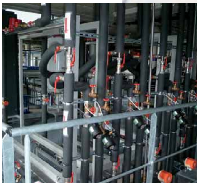
Banc expérimental de réseaux d'eau chaude sanitaire pour l'étude des risques liés aux légionnelles
