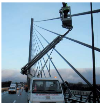
Vibration des haubans du Pont de l'Iroise
